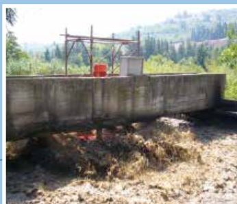
Installazione di aeratore di superficie tipo ASP-F. Installation of a surface aerator type ASP-F.
