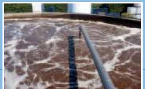
Aeratore sommerso tipo SCLK in funzione in vasca di ossidazione. Submersible aerator type SCLK working inside an oxidation tank.
