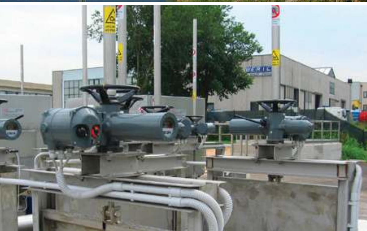
Paratoie a tenuta su tre lati motorizzate per impianto di depurazione
